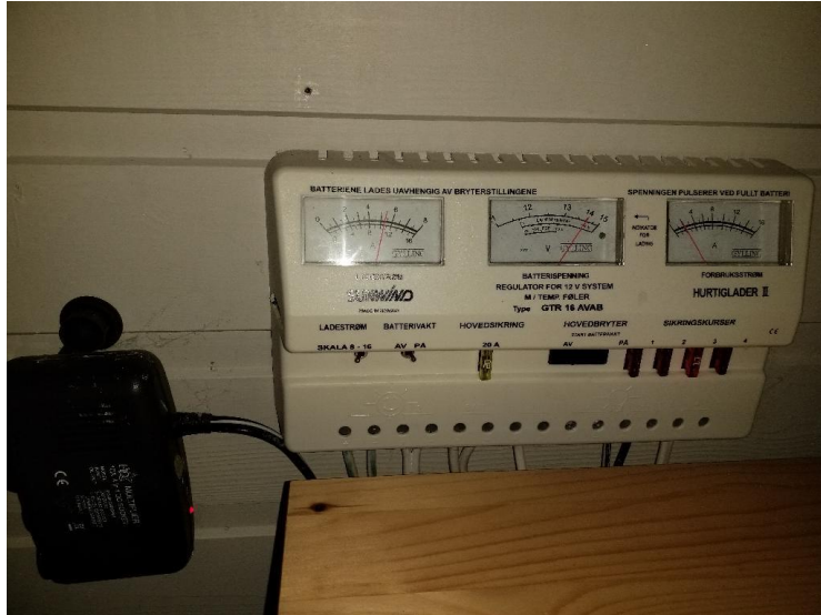
Beskrivelse - [IMG_20200826_102349 Sikringskap.]
